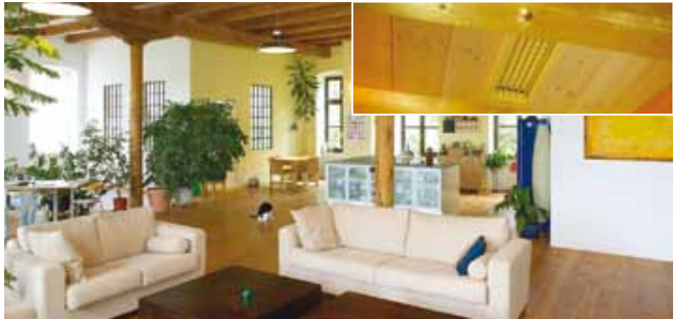
Klimatechnik kann harmonisch in die Wohnumgebung integriert werden Bild: Fotolia, KLIMAWELT SCHWEIZ
