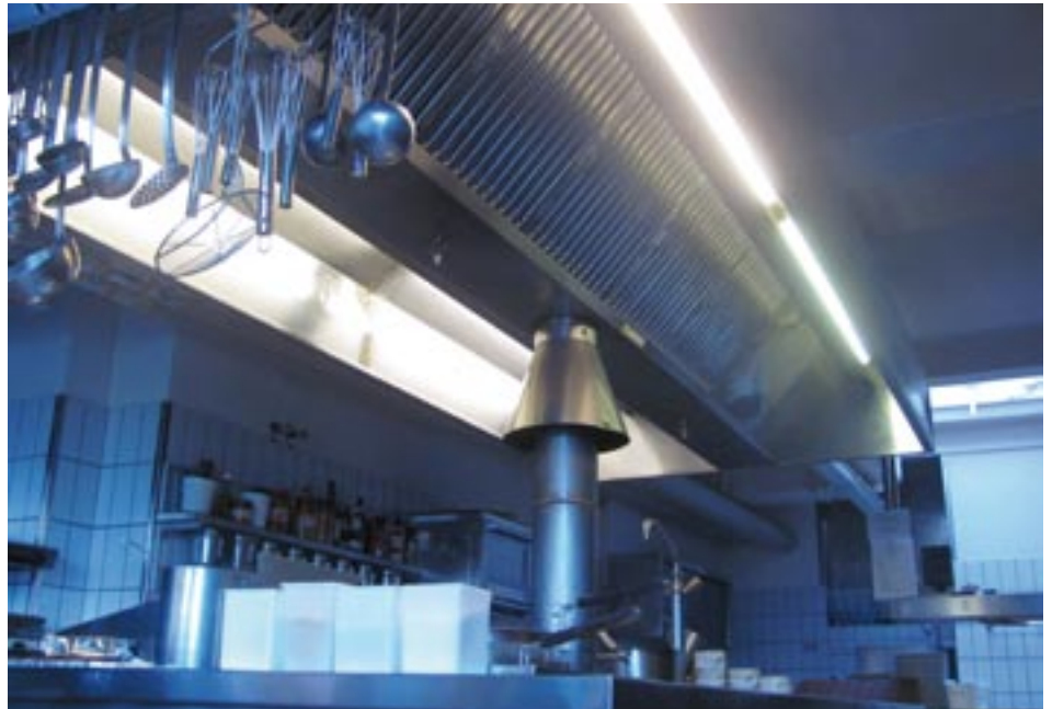
Hotel Seegarten UVC Küchenabluft
